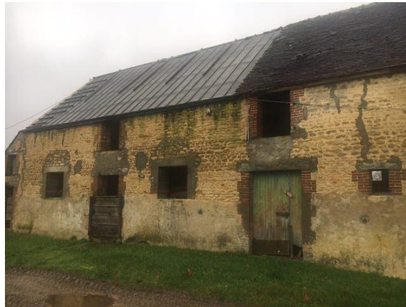
(Logement à louer, quelques réparations nécessaires. Photo : Bill)
